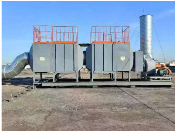
▲ 改善前現況 (風機震動)
